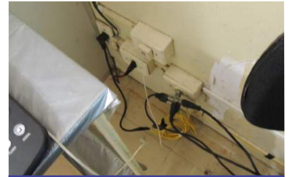
Precariedade: gambiarras ameaçam segurança do trabalhador
