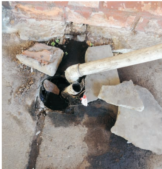
Esgoto fede a céu aberto
