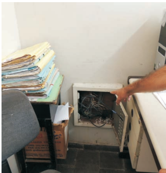
Processos parados e gambiarras elétricas
