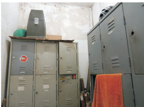
Mofo e ferrugem tomam conta do vestiário
