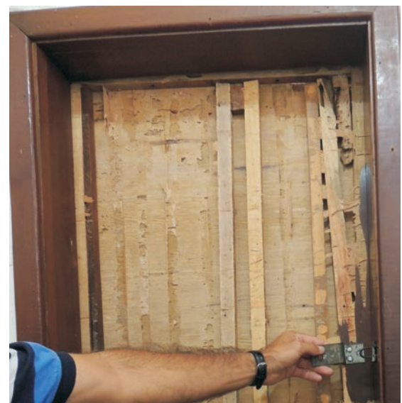
Banheiro tem porta de tapume
